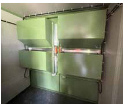
Zuluftöffnungen mit elektrischen Jalousienklappen serienmäßig
