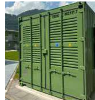
2-flügelige Wartungs- und Zugangstüren vorne mit Zuluftöffnung
