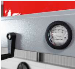
Filterüberwachung über Manometer
